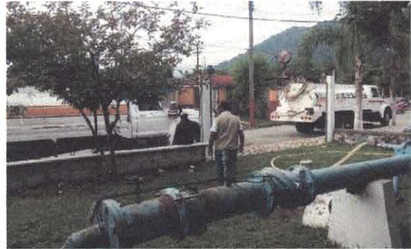
Sistema de agua El Cristo.
