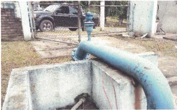
Sistema de agua del fraccionamiento Valle Dorado.
