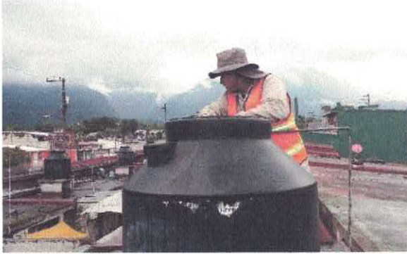
Fuga de agua en tinaco de la unidad El Cristo.
