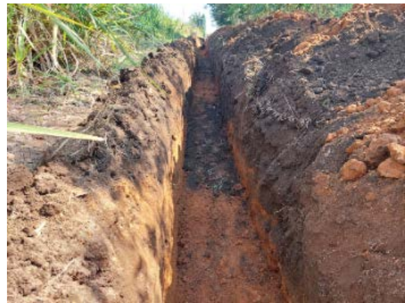
Zanjado de la obra para colocar la tubería de la red de distribución de agua potable
