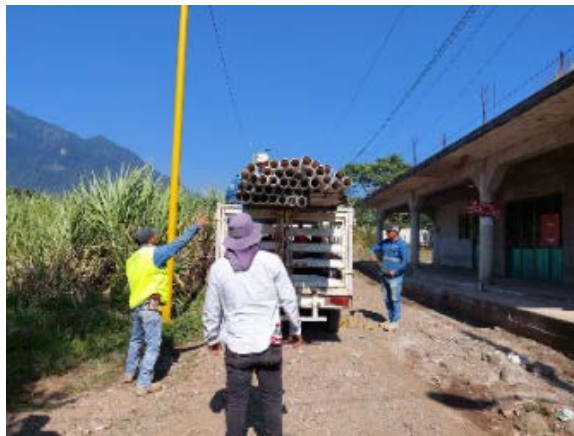
Red de agua potable en la localidad de San Isidro
